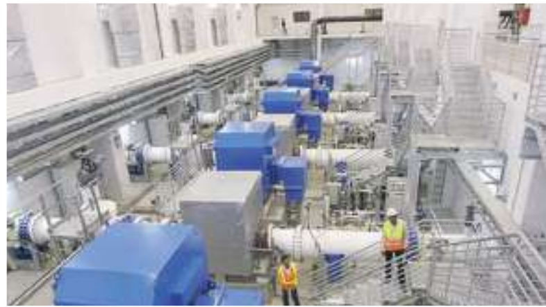
Station de pompage de l'aquifère de Disi, en Jordanie, inaugurée en 2013. L'eau fossile est destinée à satisfaire entre 20 et 25 % des besoins de la Jordanie. (AFP/Khalil Mazraawi)
